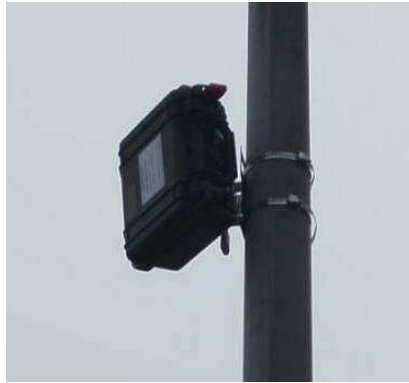
strumentazione radar Icoms TMS-SA4 installata su palo della pubblica illuminazione.
